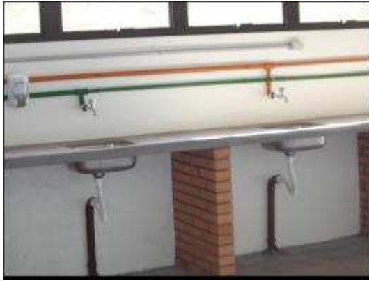
Figura 49: Tubulação diferenciada dos dois tipos de sistema de água nos laboratórios do CETEC.
