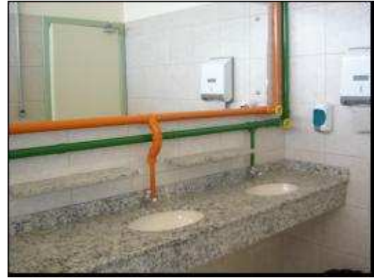
Figura 50: Tubulação diferenciada para os dois sistemas de água no banheiro do CETEC.
