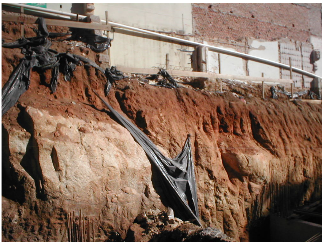
Figura 25: Ocorrência de matacão em uma obra de Porto Alegre/RS
