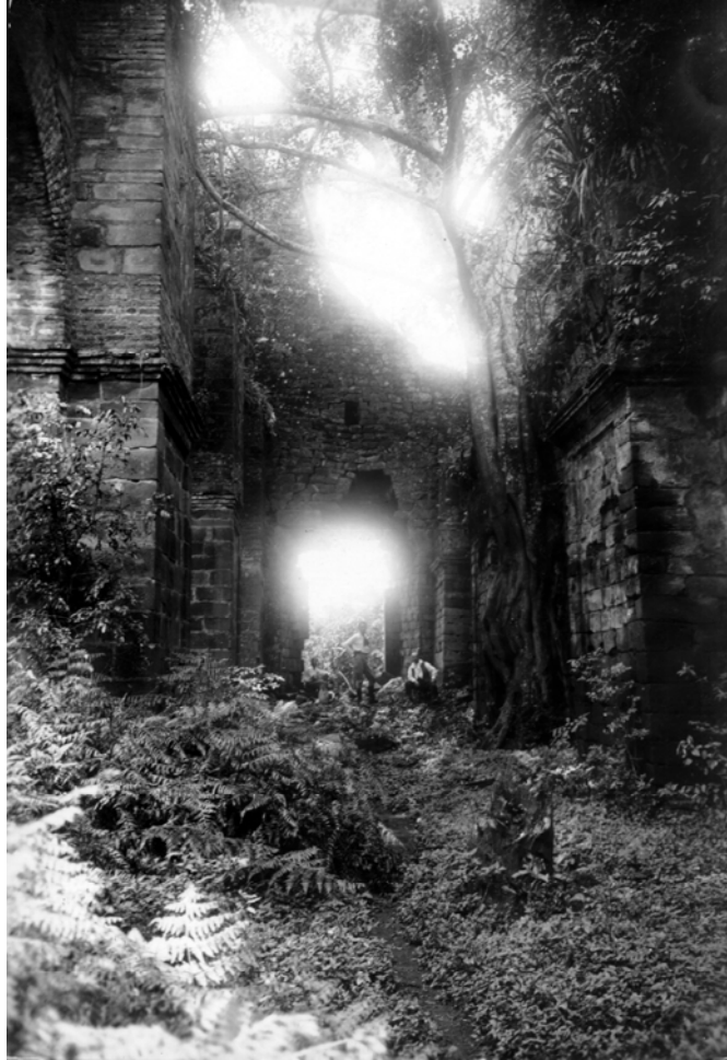
Figura 30: nave lateral lado do evangelho. Estado antes das obras de 1925 (Arquivo Noronha Santos)
