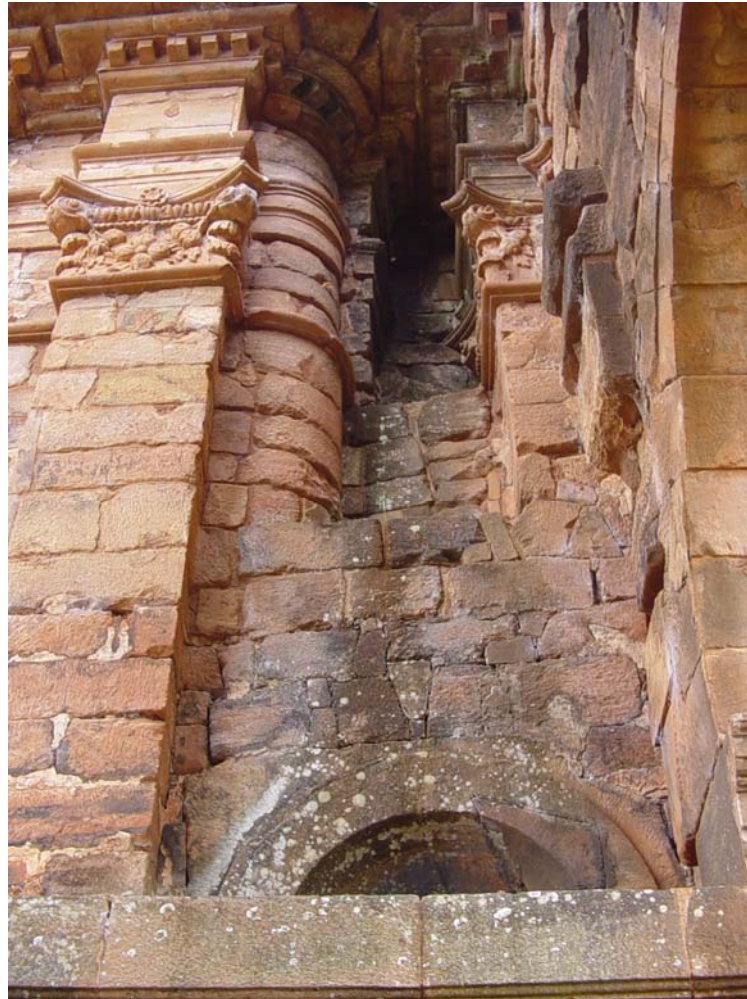
Figura 16: junção da torre com a Igreja mostrando a interferência entre as duas construções
