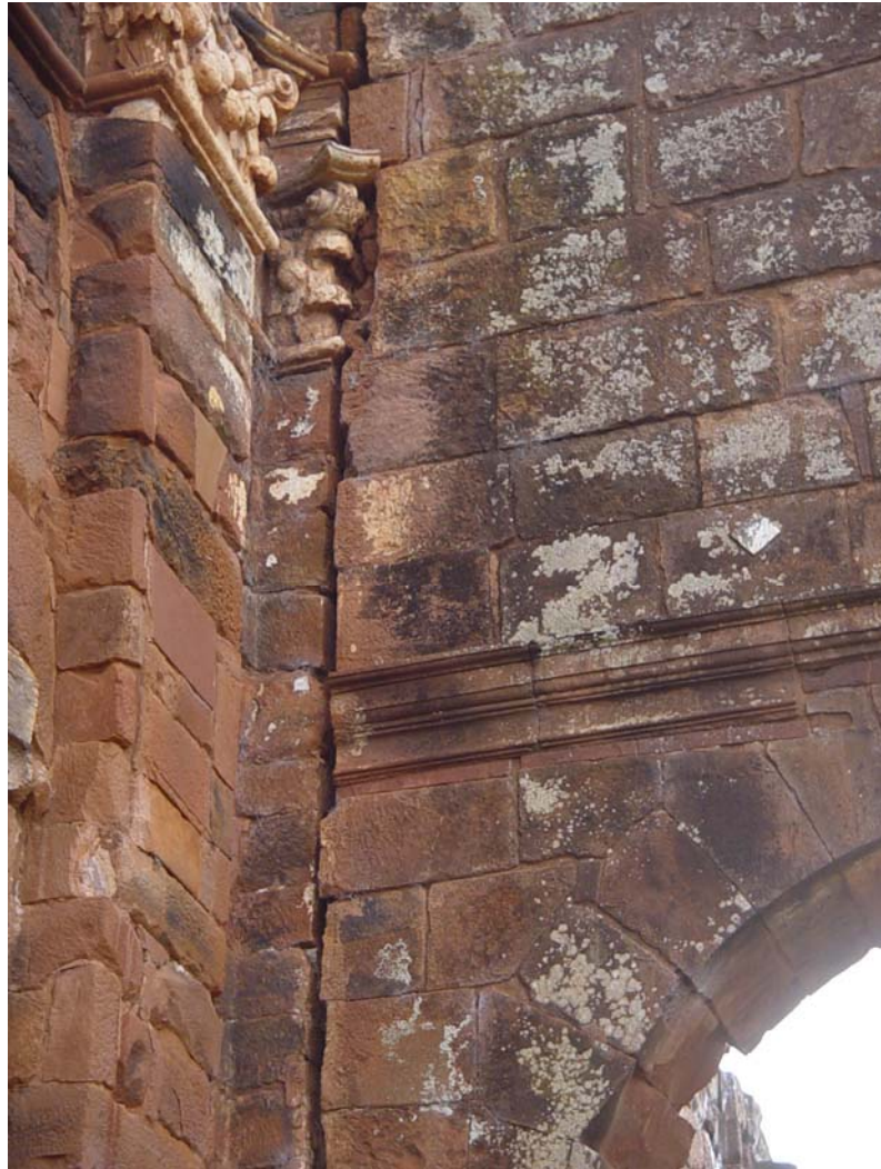
Figura 17: junta que demonstra a falta de amarração do pórtico à Igreja
