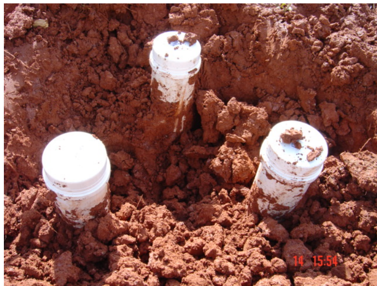
Figura 3.25 – Escavação para a retirada dos tubos para coleta das amostras indeformadas para o equipamento de colmatação.
