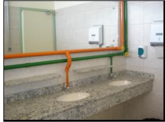
Figura 50: Tubulação diferenciada para os dois sistemas de água no banheiro do CETEC.
