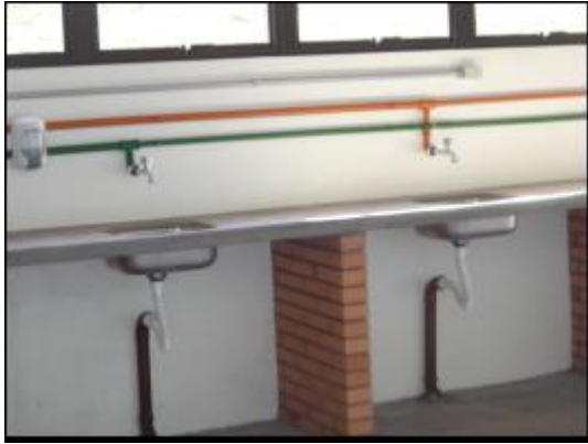
Figura 49: Tubulação diferenciada dos dois tipos de sistema de água nos laboratórios do CETEC.
