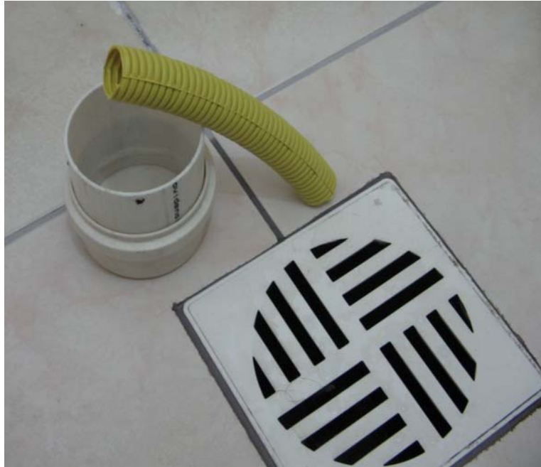
Figura 30: Tubo flexível para a coleta nos lavatórios.
