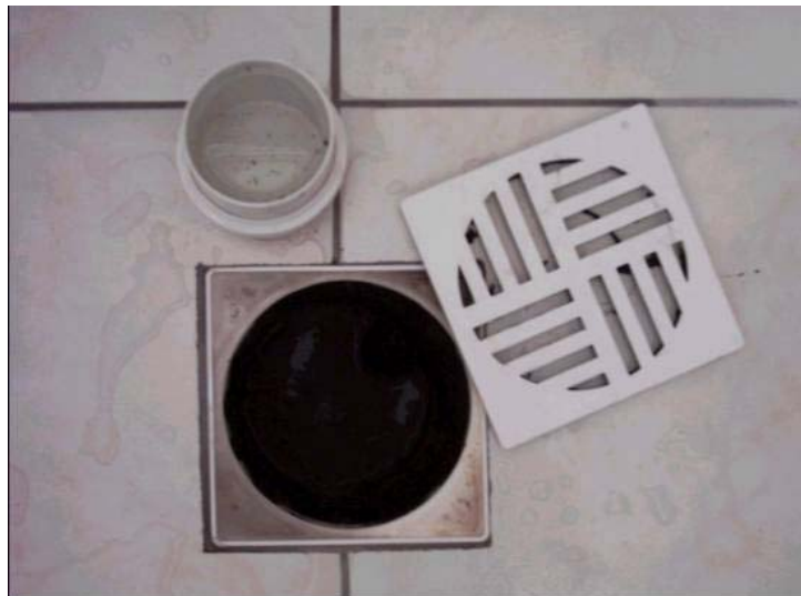
Figura 29: Coletor e caixa sifonada de um banheiro analisado.
