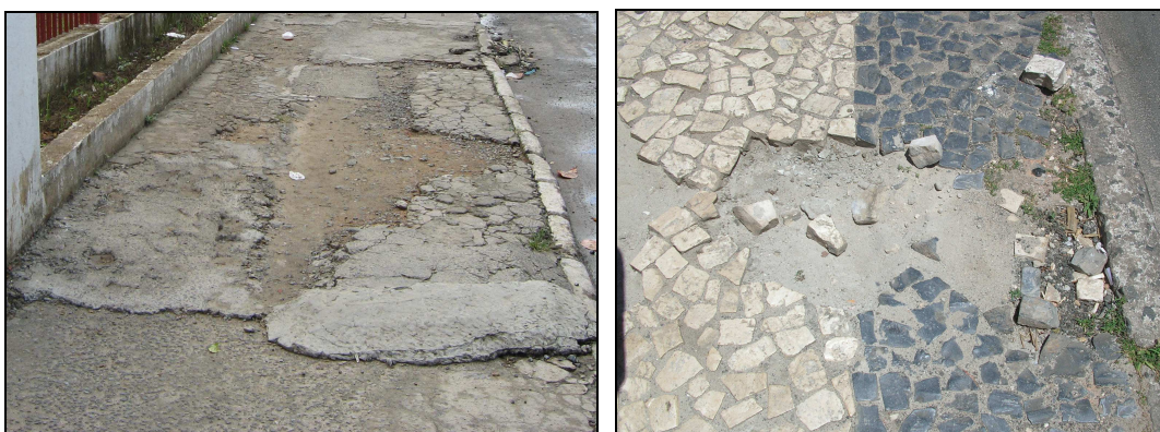
Figura 96 – Novo centro, Av. Tancredo Neves, detalhes das calçadas, com buracos Fotografia: Francisco Lacerda Brito, fev./2007.
