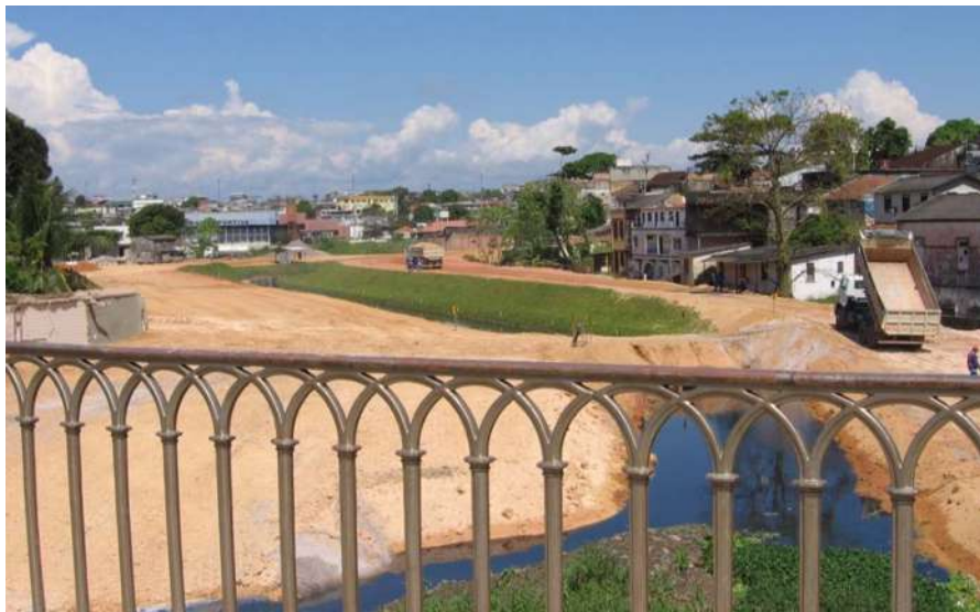
Igarapé dos Educandos em Manaus, antes e durante as obras do PROSAMIM. Fonte: o autor, 2007.
