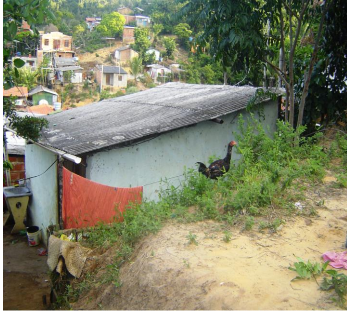
Fotos 32: Casa de alvenaria com telhado de amianto Fonte: Ernesto Pablo Mata Machado – Maio 2007
