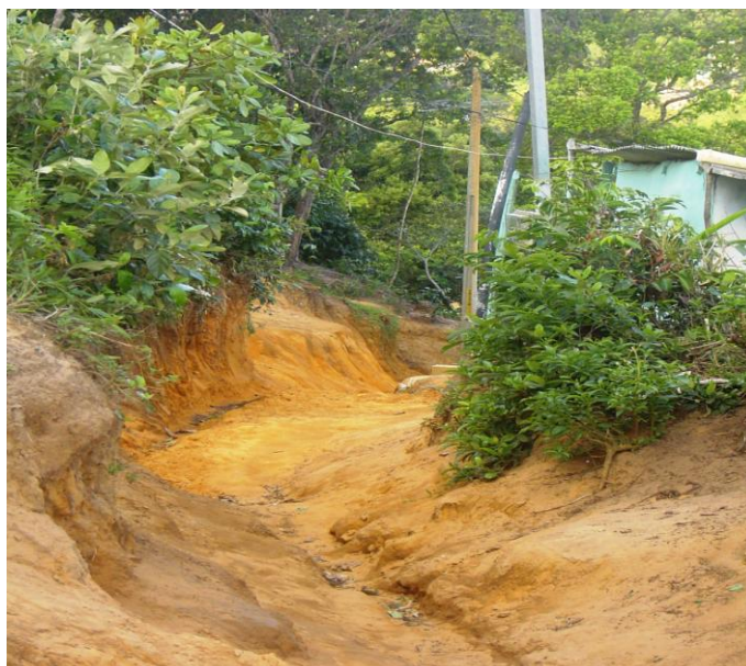
Foto 47: Processo erosivo dentro do loteamento Nossa Senhora da Luz Margem superior direita de descida à rua principal. Fonte: Ernesto Pablo Mata Machado – Maio 2007
