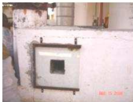
Figura 19 – Janela para visualização da chama piloto (Ch 3).
