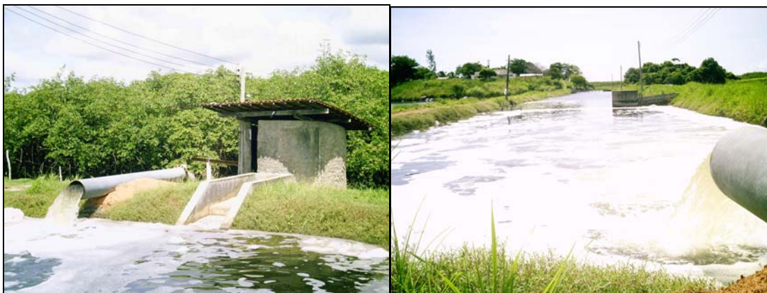
Figura 2 - Casa de bomba para captação de água do estuário e canal de abastecimento da fazenda. Fonte: o autor (2007).
