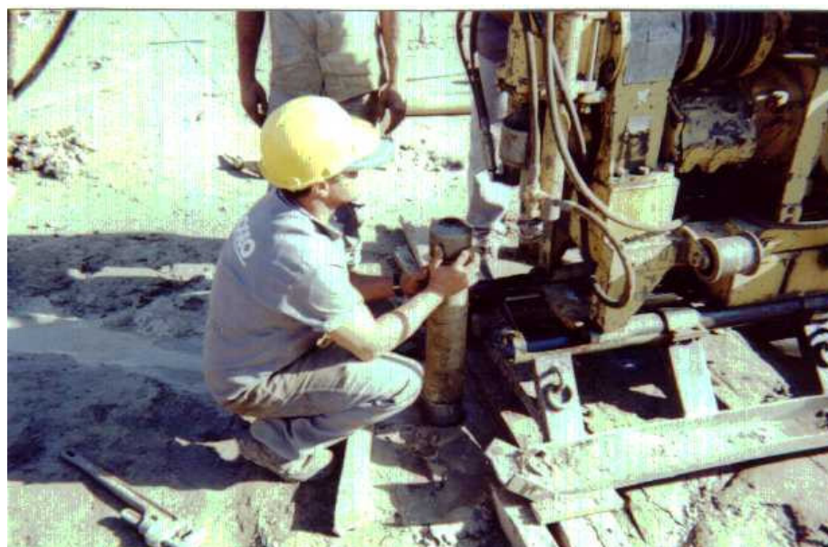
Foto 5.9 - Conexão do suporte para instalar o revestimento tipo HW em profundidade, de forma a evitar acidentes com a sonda pressiométrica.
