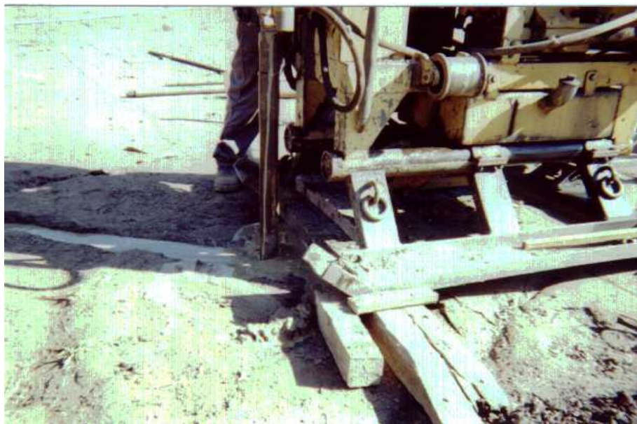
Foto 5.7 - Injeção da bentonita no furo de sondagem para a execução do ensaio pressiométrico.
