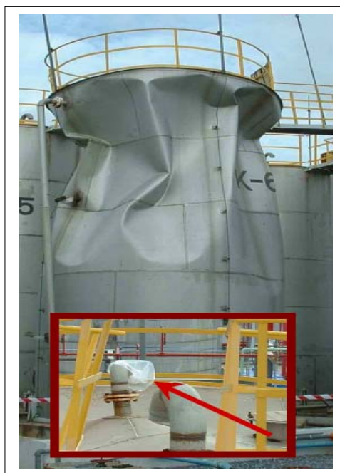
Foto 3 – Colapso de tanque devido ao respiro tamponado. Fonte: Aiche-CCPS-Process Safety Beacon– fev/07
