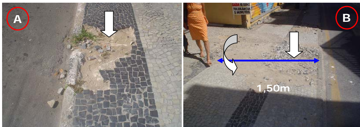
Figura 8 – Buracos encontrados nos logradouros observados, sendo foto “A”: rua 13 de Maio; foto “B”: rua Carlos de Lacerda.
