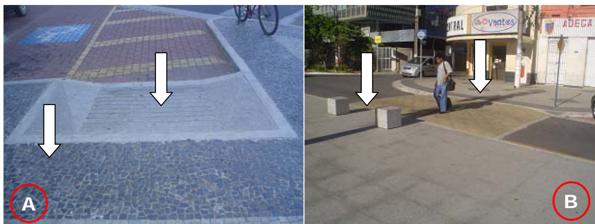
Figura 26 – Ausência de sinalização tátil de alerta em rebaixamento de calçada (foto “A”) e ausência de sinalização tátil de alerta e faixa indicativa de travessia de pedestres em piso elevado (foto “B”), na Praça São Salvador.
