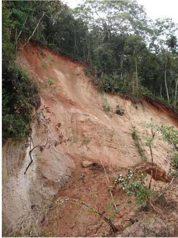
Figura 1. 2 – Deslizamento em um corte de estrada.
