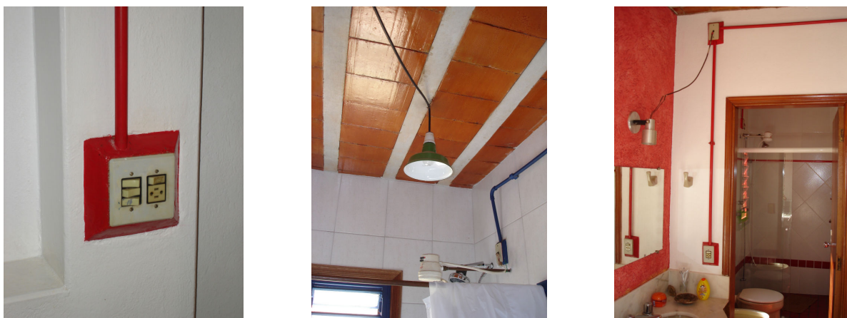
Figura 4.35. – Instalações elétricas – res. Wilson Cano Fotos: o autor
