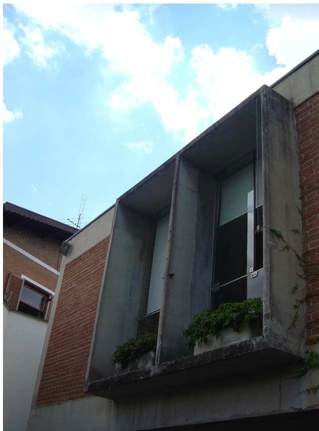
Figura 2.14. - Pré-fabricação – batente-brise de concreto para janela – res. Paulo de Tarso B. Duarte. Foto: o autor
