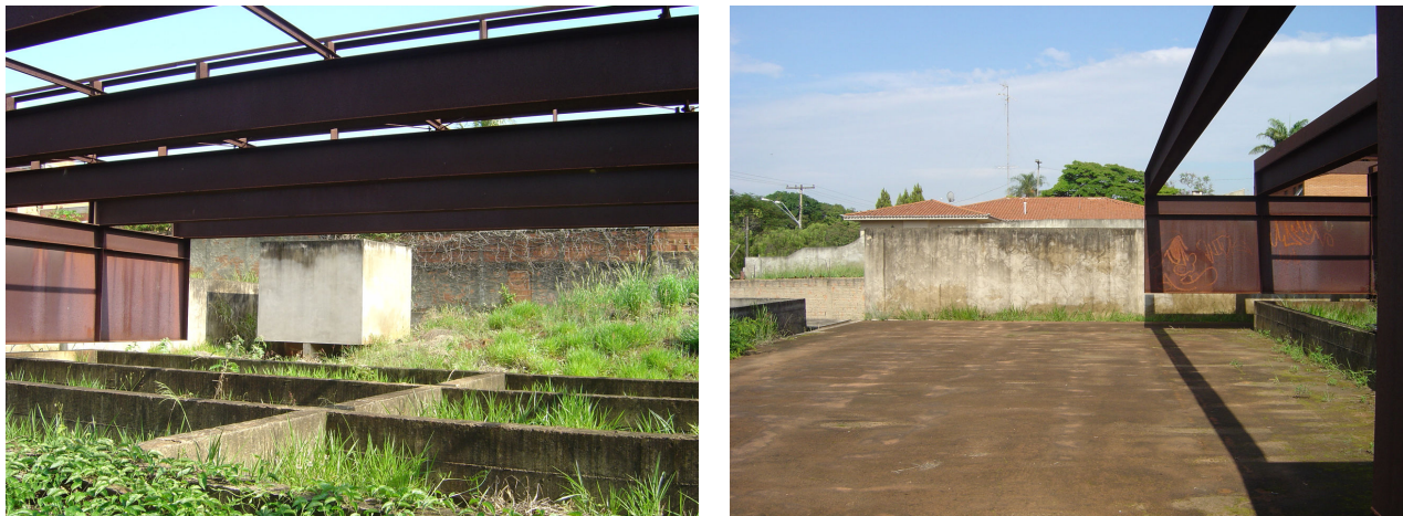
Figura 4.40. – A base elevada (porão), a lavanderia (ao fundo) e o pátio-terreiro – res. Paulo Roberto da Costa Santos Fotos: o autor
