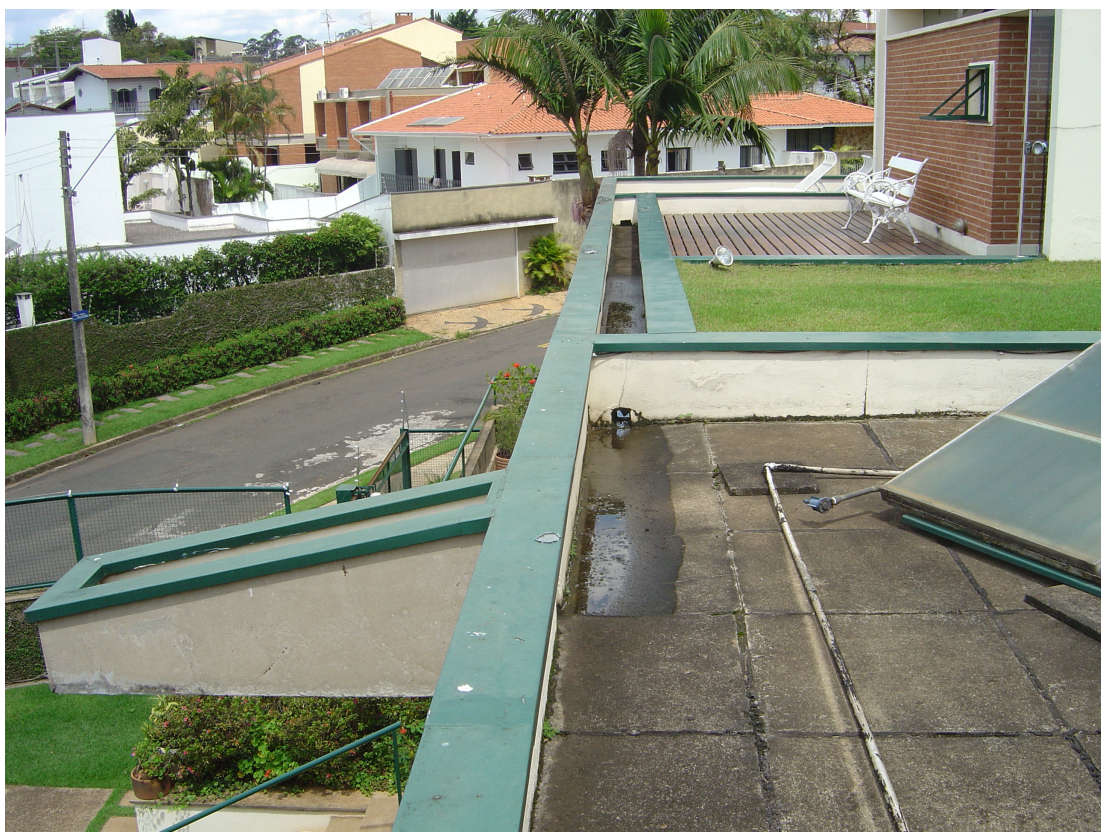
Figura 2.17. - Detalhe do sistema de impermeabilização da laje de cobertura – res. Paulo de Tarso B. Duarte Foto: o autor
