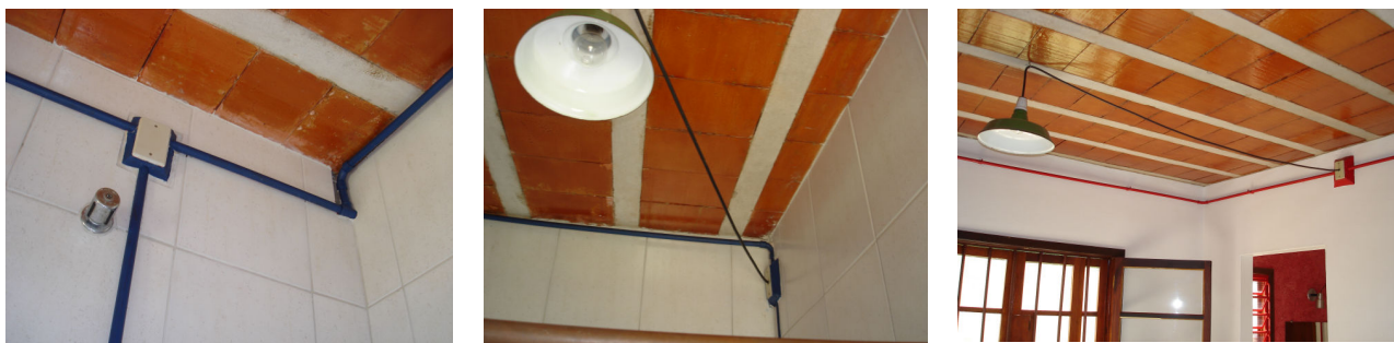
Figura 4.36. – Instalações elétricas – res. Wilson Cano Fotos: o autor
