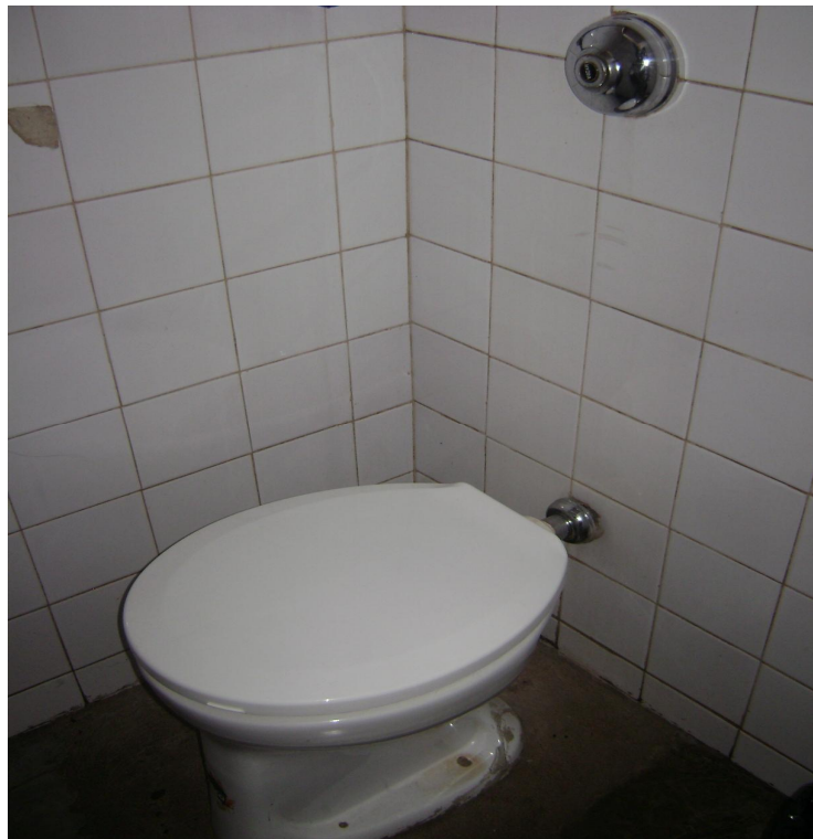
FOTO 17: Banheiro próximo à sala da direção (bacia com válvula de descarga). FONTE: CROSARA R. set. 2008.
