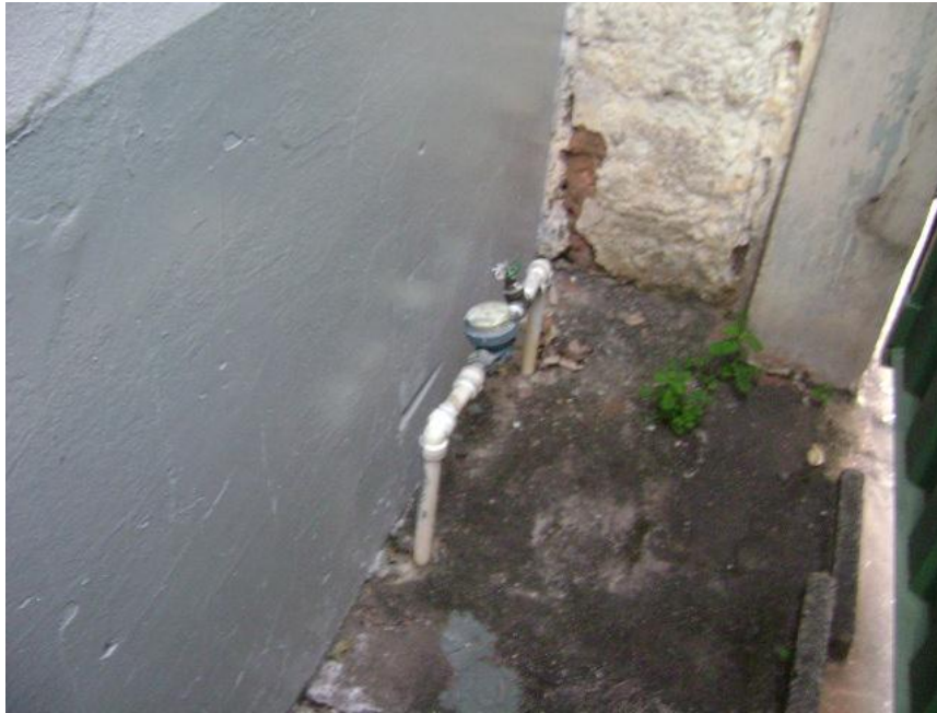
FOTO 14 - Hidrômetro nº. 1 – Localizado próximo ao portão da Rua Curitiba. FONTE: Crosara, R. ago. 2008.
