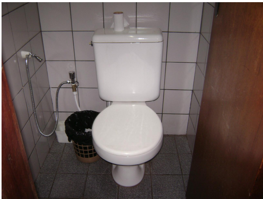
FOTO 18 – Banheiro dos professores (bacia com caixa acoplada) FONTE: CROSARA, R. set. 2008.
