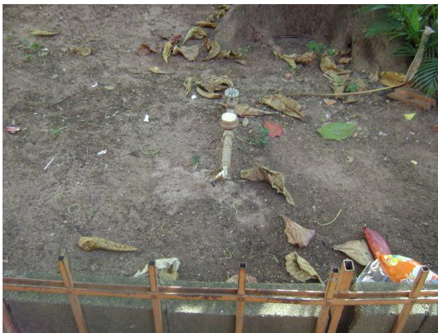
FOTO 15 - Hidrômetro nº. 2 – Localizado próximo ao portão Rua Osório José da Cunha. FONTE: Crosara, R. ago. 2008.
