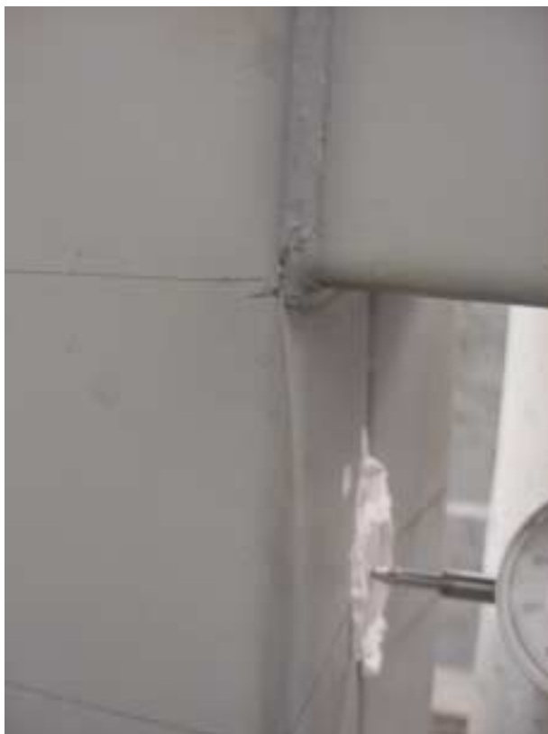
Figura 4.17 – Foto que mostra o mecanismo de colapso da ligação do protótipo P01.
