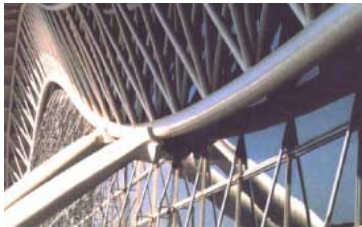
Figura 2.29 – Detalhe de treliça espacial triangular curva. Aeroporto Kansai em Osaka, do arquiteto Renzo Piano. Fonte: Eekhout, 2001.
