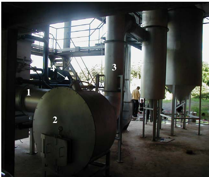
Figura 17: Vista do reator de oxidação (1.zona secundária de combustão; 2.zona terciária de combustão; 3.zona quaternária de combustão; 4.queimador)
