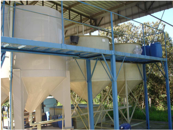
Ponto 1 – Estação de Tratamento
