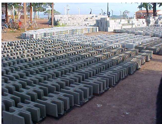
Foto 27: Estoque de blocos produzidos para abastecer as equipes de construção de unidades habitacionais (AMARAL, 2004).
