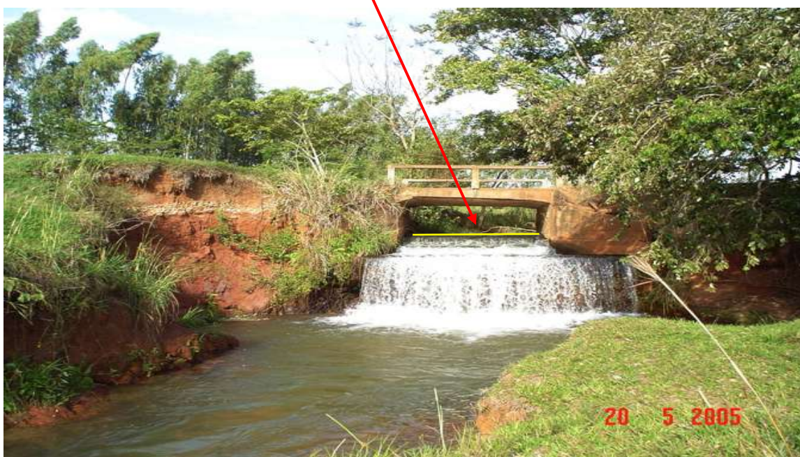
Figura 137: Cachoeira do Tranin - Ponte sobre o córrego Água da Marilena. Verifica que a construção da mesma e de uma barreira para formar a cachoeira (indicada pela linha amarela) dificultou o acesso por parte da areia assoreada e que vem sendo arrastada pelas águas do córrego. Parte desse material sedimentado está acumulando-se próximo a sua margem, acima da cachoeira (indicado pela seta vermelha e figura acima). Ao mesmo tempo a erosão vem expondo um perfil, mostrando as várias composições do solo neste local (evidenciado acima). Fonte: COSTA, S. B. (Maio/2005; Junho/2008).
