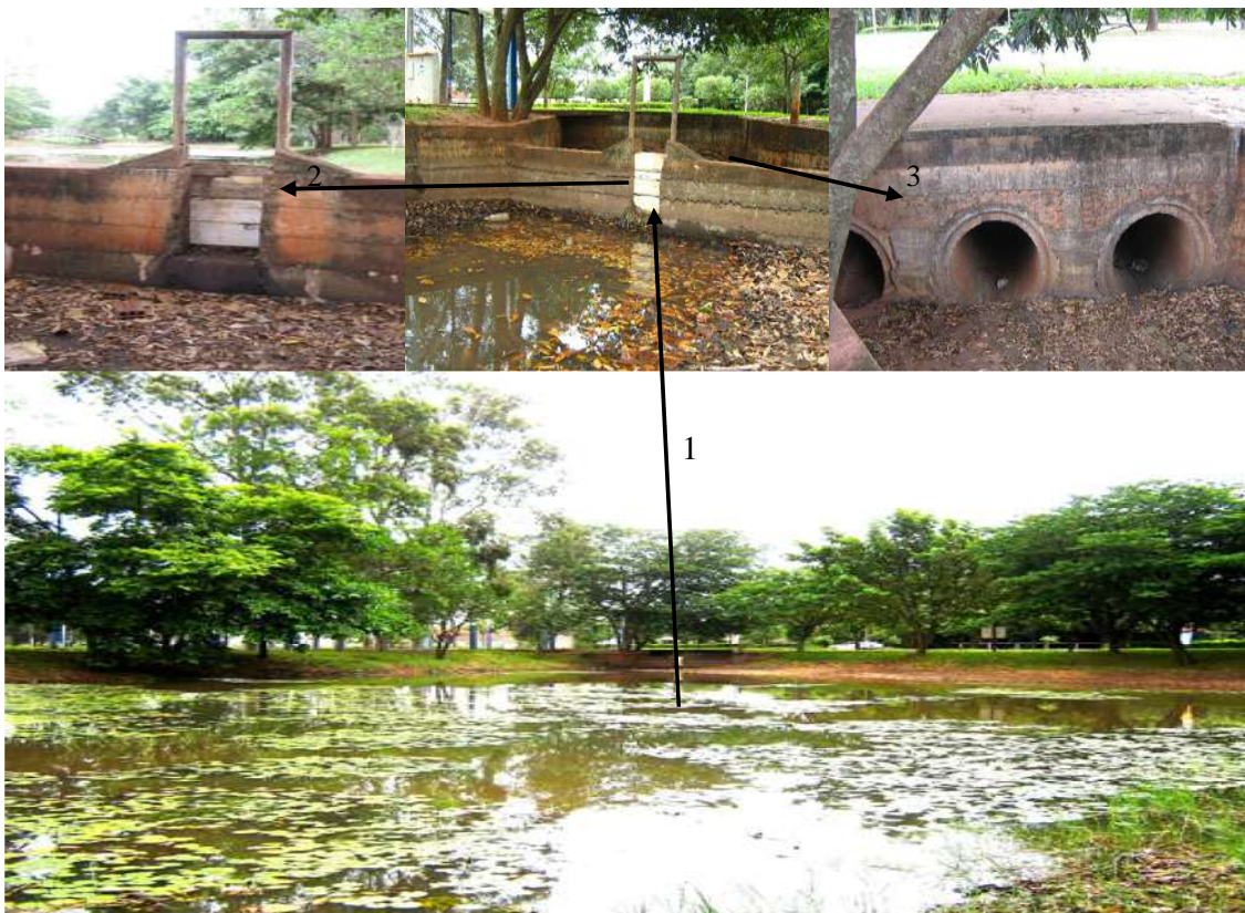
Figura 100: Comparações da paisagem do córrego Água da Marilena (III). O baixo nível das águas do córrego Água da Marilena fazem com que as águas não consigam atingir o local da canalização. A seta nº 1 evidencia a comporta e ao mesmo tempo, que o baixo nível das águas
