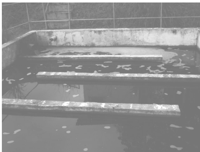
Figura 6 – ETE de São Lourenço da Serra, SP - Tanque de cloração.
