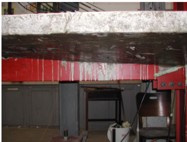
Figura 5.19 – Foto do desnivelamento da laje ocorrido no Protótipo B-E2.
