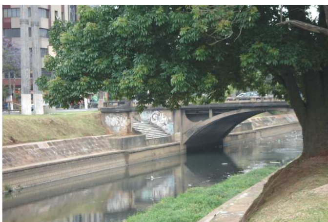
Fig. 153- Avenida Ipiranga. Ponte sobre a Avenida Getúlio Vargas: Destaque para a escadaria e sua degradação. Foto da autora, 2008.
