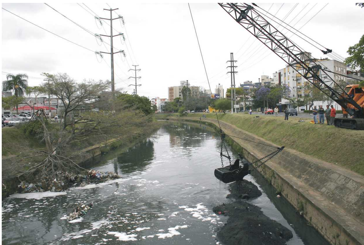
Fig. 159- Avenida Ipiranga: Dragagens periódicas evitam o transbordamento do canal. Foto da autora, 2008.
