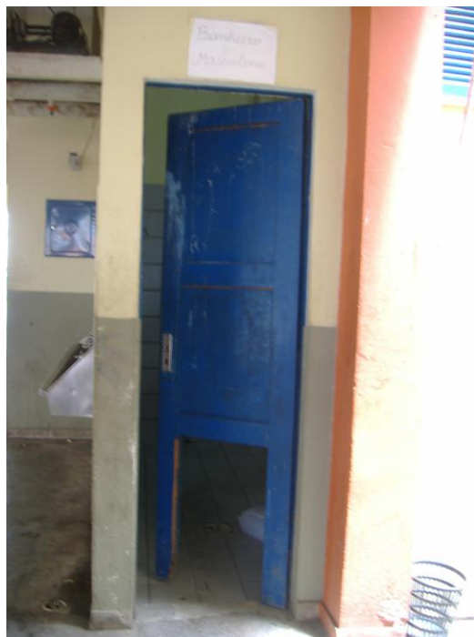
Fotografia 10: Porta de banheiro quebrada em uma escola do bairro da Pedreira
