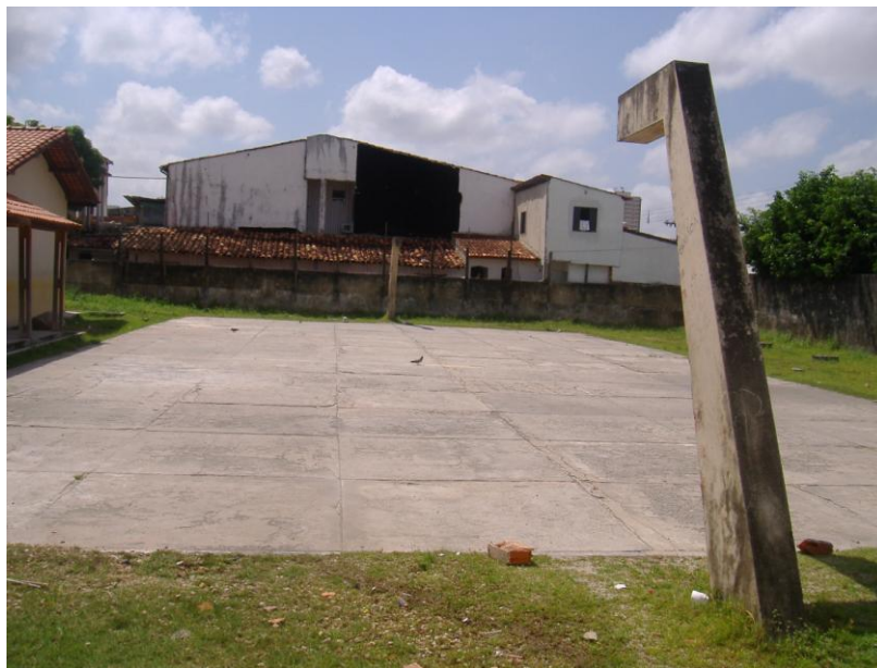
Fotografia 24: O muro baixo permitia a entrada de desocupados na escola
