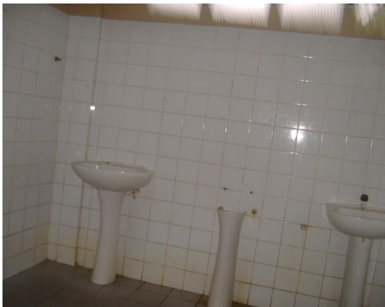
Fotografia 2: Louças sanitárias destruídas
