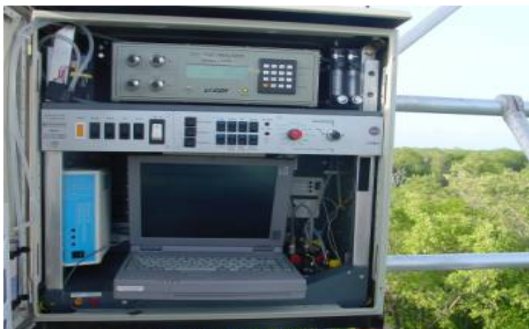
Figura 6 – Sistema EDISOL instalado no manguezal natural de Bragança.
