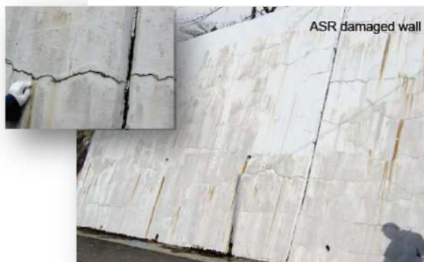
Figura 2.35: Muro de contenção na cidade de Gifu, Japão, danificado por reações álcali-agregado [fonte: Rokugo et al. , 2005]
