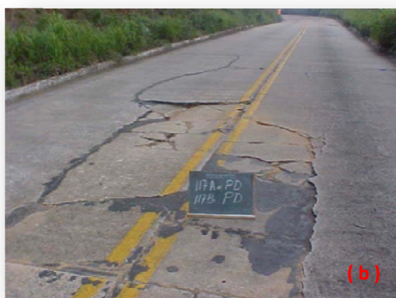
Figura 1.1: Exemplos de processos de deterioração em elementos do sistema de transporte rodoviário: (a) processo corrosivo com perda de camada de revestimento [fonte: ASCE, 2005] e (b) placa rompida [fonte: DNIT 061/2004]
