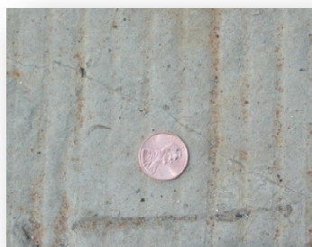
Figura 2.34: Fissura presente na laje de ligação. Abertura das fissuras se mantém entre 120 a 170 \mu\text{m} .
