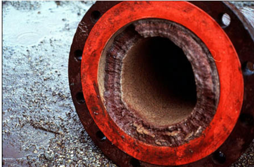
Figura 8: Incrustação numa tubulação de distribuição de água. Adaptado de GE Water Technology.
