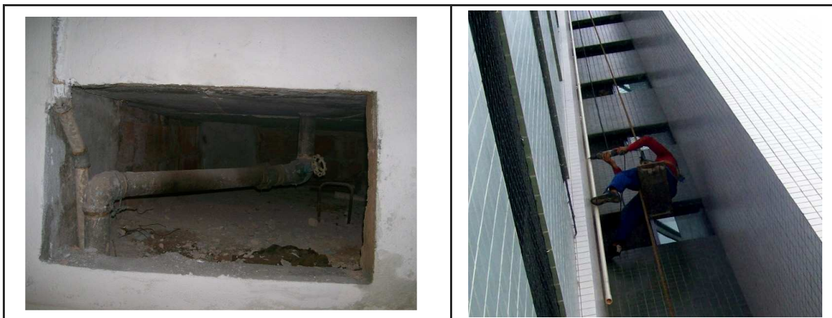
Fonte: Pesquisa de campo Fig. 7.3 - Dificuldade de acessibilidade às instalações hidráulicas do ramal principal - Obra C
