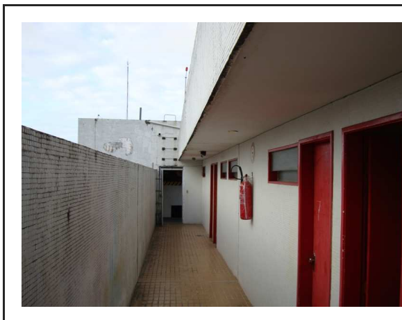
Fonte: Pesquisa de campo Fig. 7.13 - Impossibilidade de instalação de andaime na fachada posterior - Obra B
