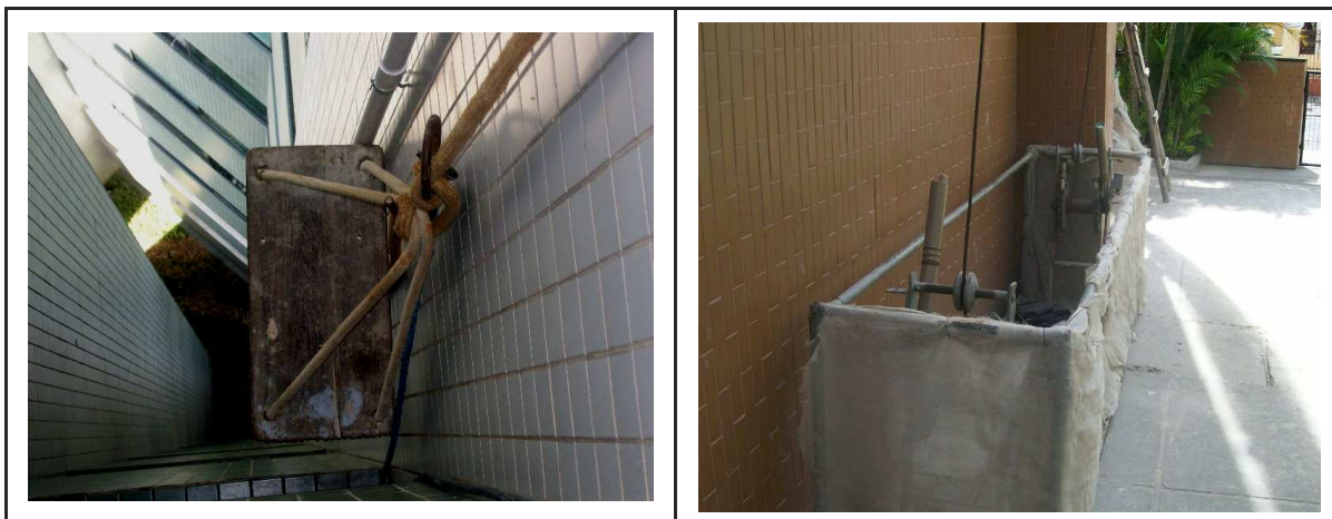
Fonte: Pesquisa de campo Fig. 7.18 - Cadeira suspensa inadequada, sem cabo guia independente para o cinto - Obra F
