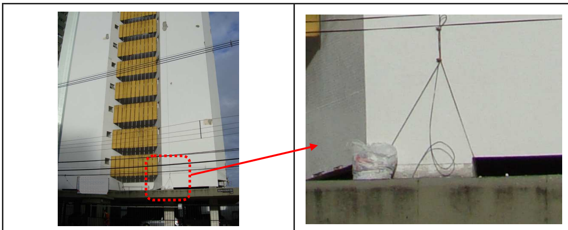
Fonte: Pesquisa de campo Fig. 7.8 - Arranjo inadequado do cabo de sustentação da estrutura - Obra A
