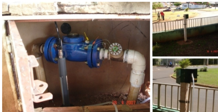
Figura 5.11 - Ponto de instalação - Sonda 2.
