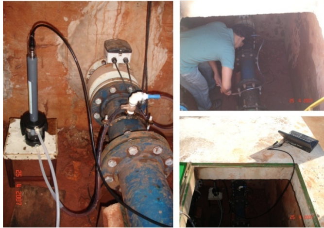
Figura 5.10 - Ponto de instalação - Sonda 1.
