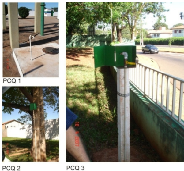
Figura 4.5 - Detalhe dos PCQs.
