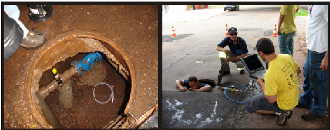
Figura 5.29 - Ponto de instalação da sonda 2.
