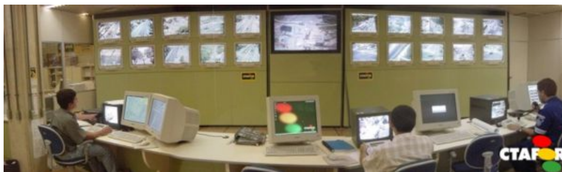
Figura 51. Painel de controle do CTA-FOR. Fonte: CTA-FOR 309 (2007).
