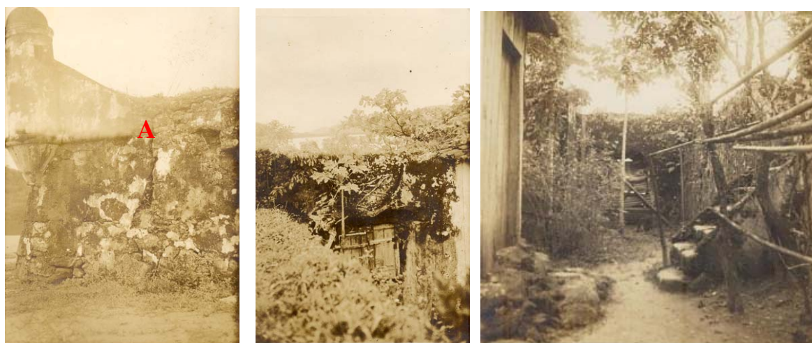
Figura 16. (A) Rachadura do lado esquerdo. Figura 17. Residência do zelador. Figura 18. Escada de acesso à plataforma
