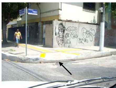
Fig.55 - Rota acessível associada à faixa de travessia. Fonte: acervo da autora.
