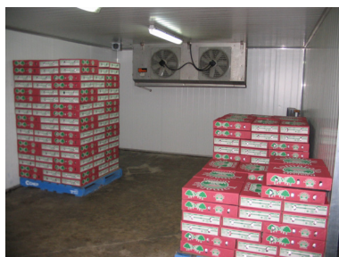
Figura 78 - Armazenamento refrigerado. Austrália
