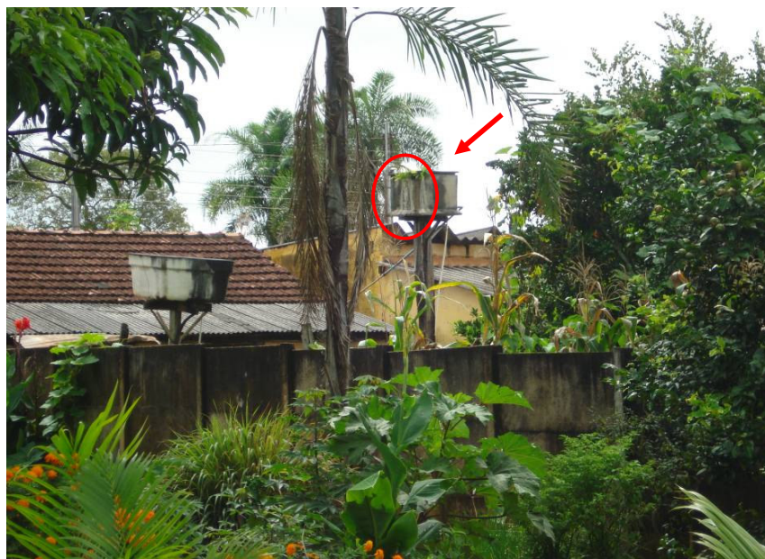
Foto 24: Planta nascendo na rachadura da Caixa d'água, que estava com tampa improvisada.
