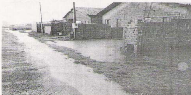
Os alagamentos são frequentes e as casas, abaixo do nível da rua, enchem de água. O prejuízo é crônico.
