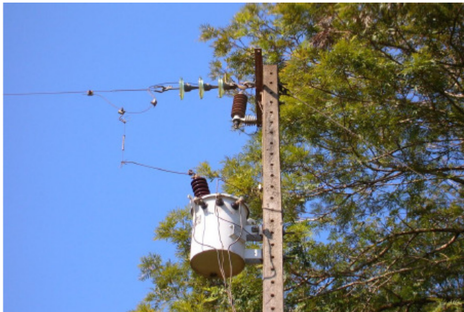
Figura 49 Posto de Transformação Monofásico 19,9 [kV] (MRT)
