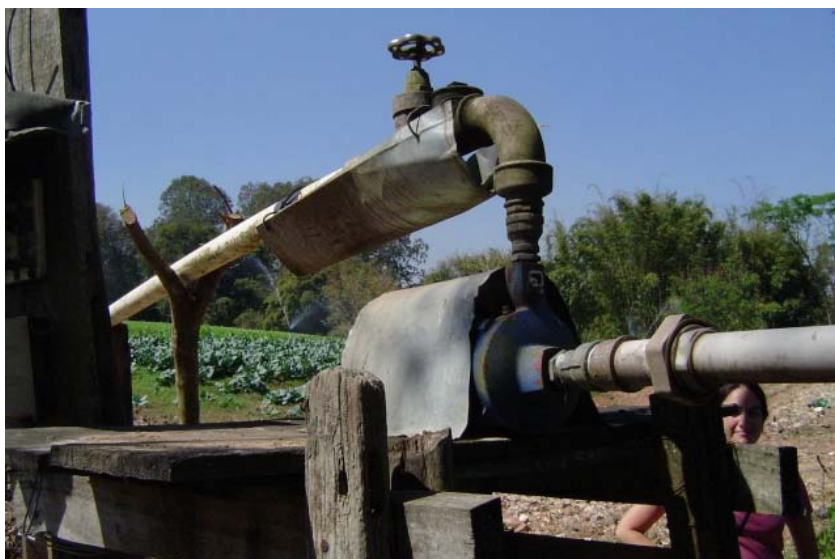
Figura 7 - Bomba de captação de água em propriedade agrícola da BHRM: condições precárias
