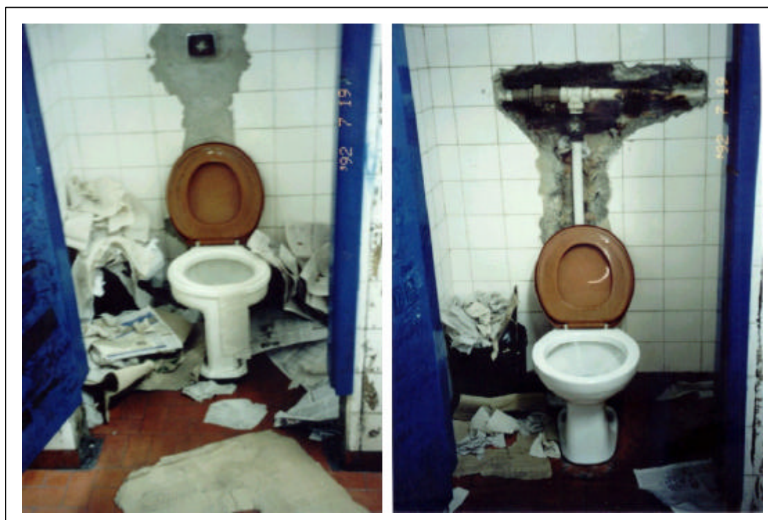
FIGURA 19 – Banheiro: Gestão anterior.
