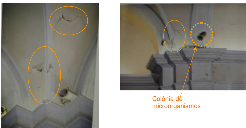
Figura 77 - Forro de estuque da nave central da Catedral. Destaque para as fissuras Local: Nave Central da Catedral acima do coro
