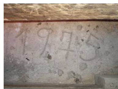
Figura 86- Registro da argamassa do forro de estuque.
