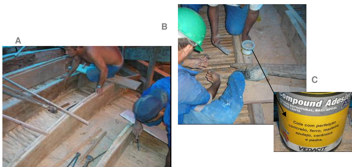
Figura 84- Imagens da colocação dos fios de cobre para fixar o forro de estuque. A) operários removendo as áreas fragilizadas e limpando as sujidades entre os ripamentos do forro de estuque B) operários trabalhando na colocação dos fios de cobre revestido e fixação com resina epóxi C) detalhe do adesivo epóxi utilizado para fixar os fios de cobre junto ao “bolo” Fonte: Acervo da autora-2006
