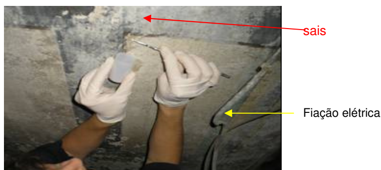
Figura 112 - Coleta das eflorescências sobre a pintura mural. Local: parede lateral esquerda, atrás do retábulo de N. Sr a . das Dores. Fonte: Acervo da autora, 2006.
