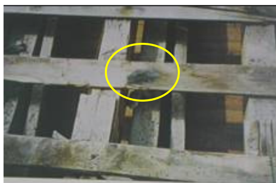
Figura 65 - Imagem da cobertura da Catedral, no destaque mancha de carbonização- 01/08/2000. Acervo FCC- Dir. de Patrimônio/ Relatório: fev./2001
