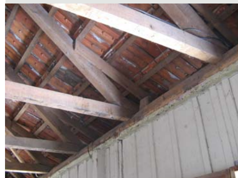
Figura 3.79 Detalhe da deflexão do telhado. Casa Rua Mateus Leme em Curitiba-PR. Foto do autor, 2006.
