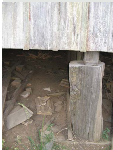
Figura 3.72 Detalhe do pilarete de fundação em madeira de alta densidade. Papanduva-SC Foto do autor, 2006.
