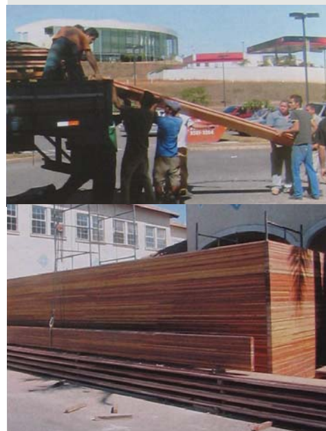
Figura 6.69 e Figura 6.70 Detalhe do painel e foto da montagem. Fonte: Revista Arquitetura e Construção, novembro de 2005.
