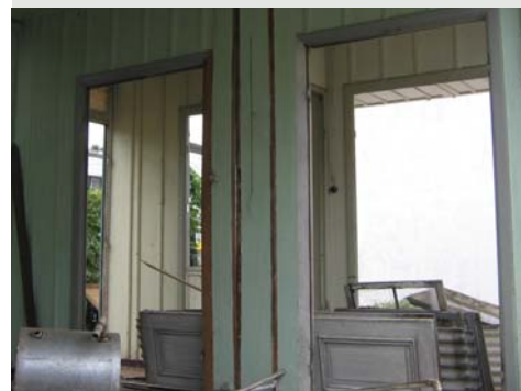
Figura 3.70 Detalhe das peças de uma Casa de Araucária do início do século sendo demolida. Rua Trajano Reis em Curitiba-PR. Foto do autor, 2007.
