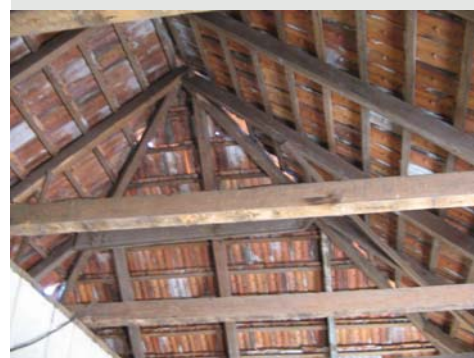
Figura 3.78 Detalhe da tesoura em linha alta no telhado de quatro águas. Casa Rua Mateus Leme em Curitiba-PR. Foto do autor, 2006.
