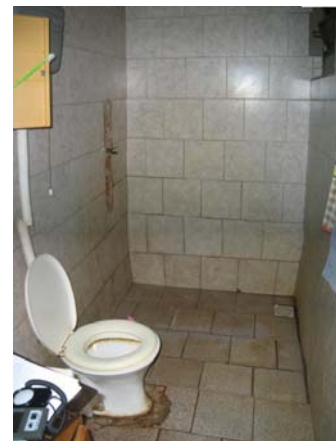
Figura 5.34: Banheiro da UH NE H2-8, escuro.
