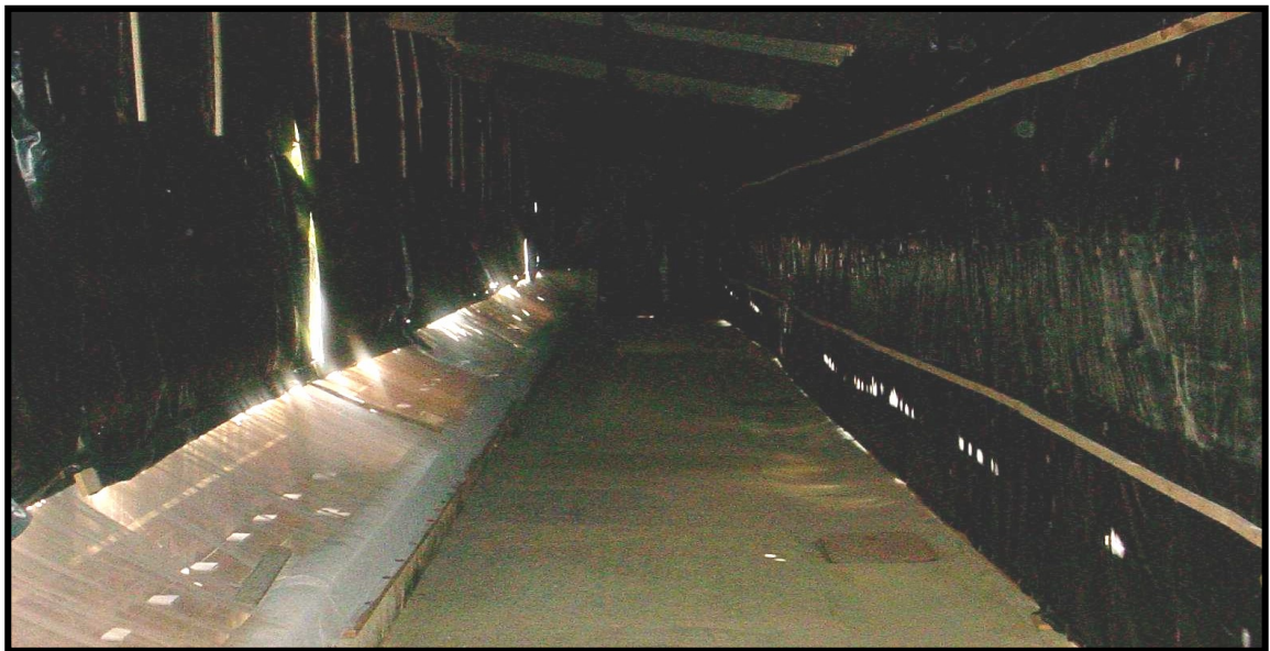
Figura 15: Sistema de aquecimento utilizado no inverno.
