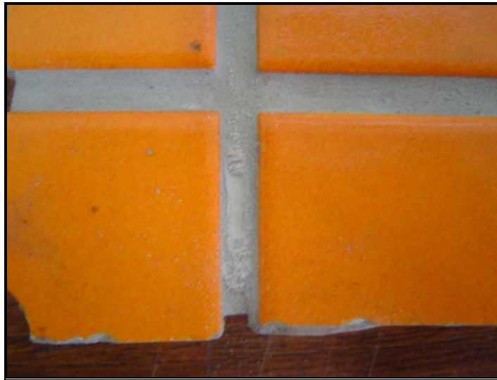
Figura 5.33 – Detalhe da desagregação do rejuntamento com a amostra H60P0, submetido à Câmara Climática, após riscamento com objeto pontiagudo.
