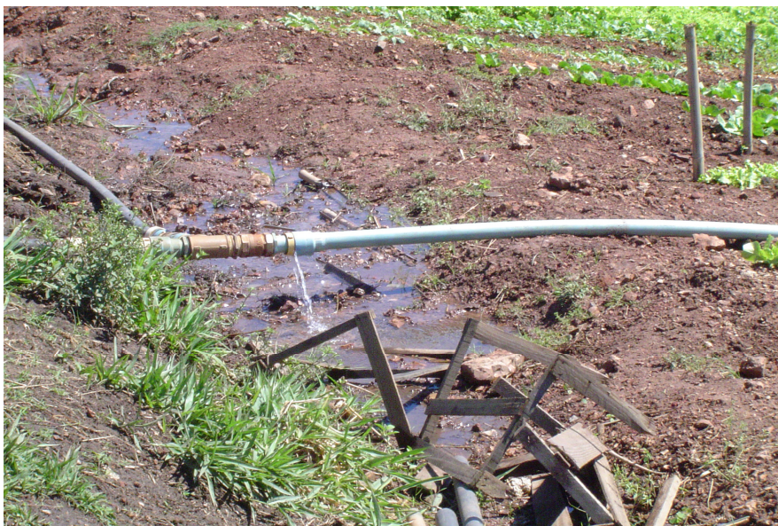
Figura 48 – Detalhe do vazamento de água em uma propriedade produtora de hortaliças na microbacia hidrográfica do ribeirão dos Marins por falta de manutenção adequada
