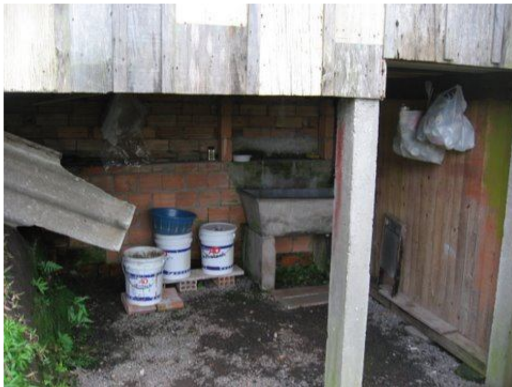
Figura 4 - Casa 02, lado esquerdo, porão úmido e com pouca luminosidade.
