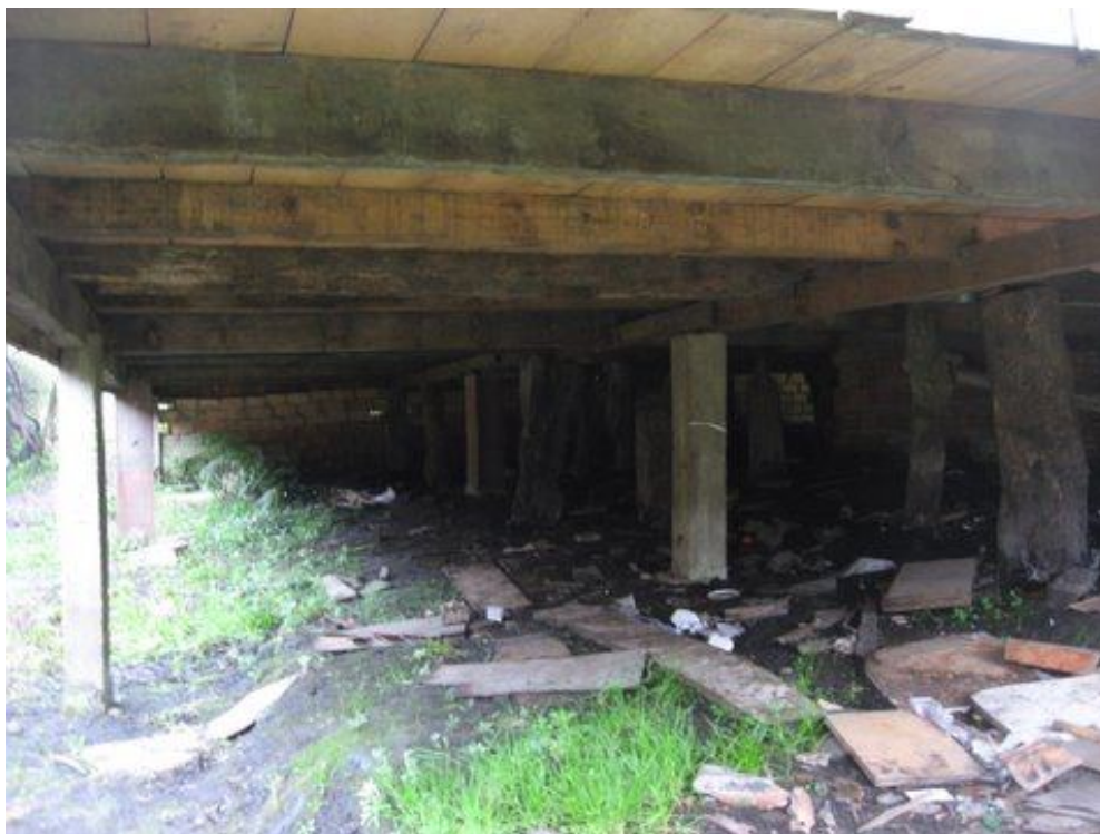
Figura 7 - Casa 04, embaixo, com presença de lixo, umidade e pouca luminosidade.
