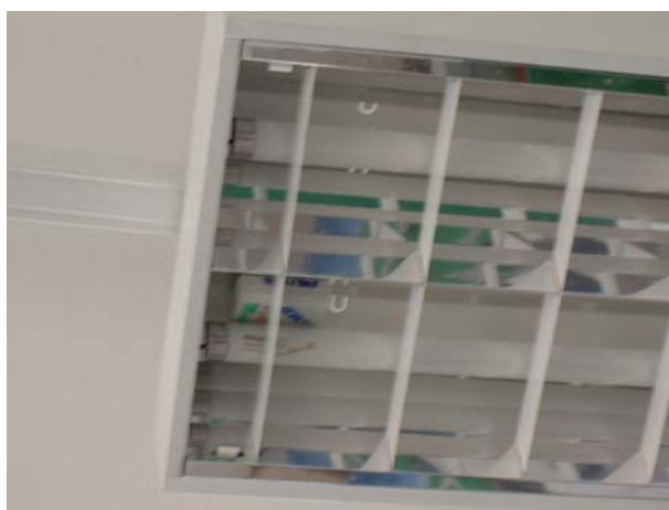
Figura 3-15. Instalação do aparelho Hobo light on/off na luminária L1.
