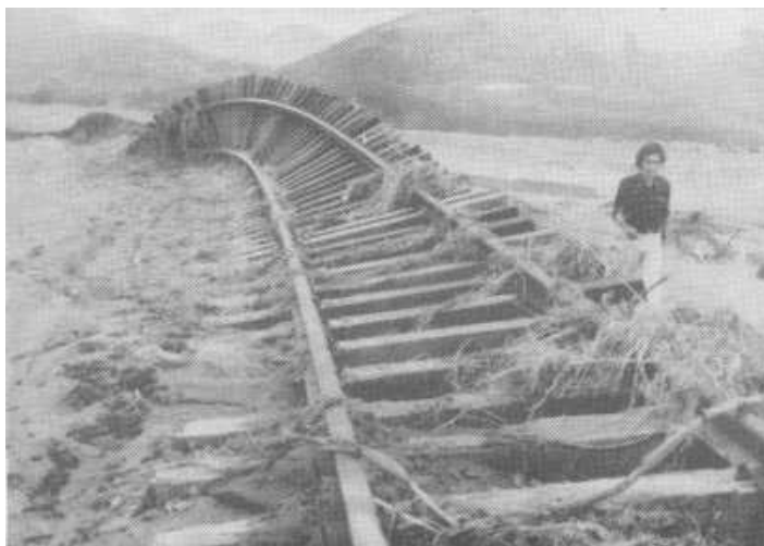
Figura 83 – Linha Férrea na enchente de 1974, atualmente leito da SC-440 – localidade km 60. Fonte: Arquivo Histórico Municipal.
