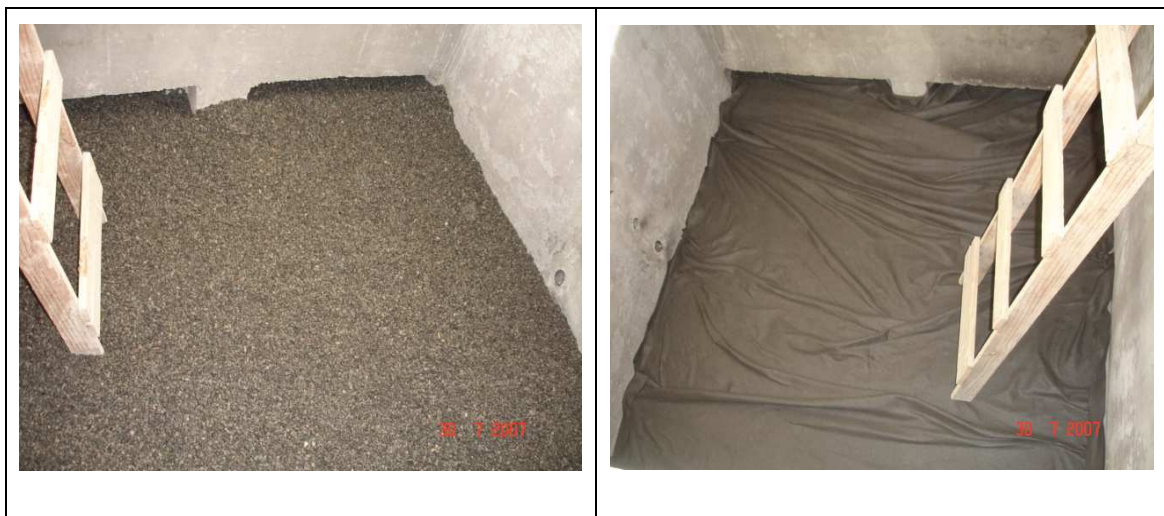
Figura 4.25: Colocação de lastro de brita e manta geotêxtil para proteger os ralos de drenagem do tanque-teste.
