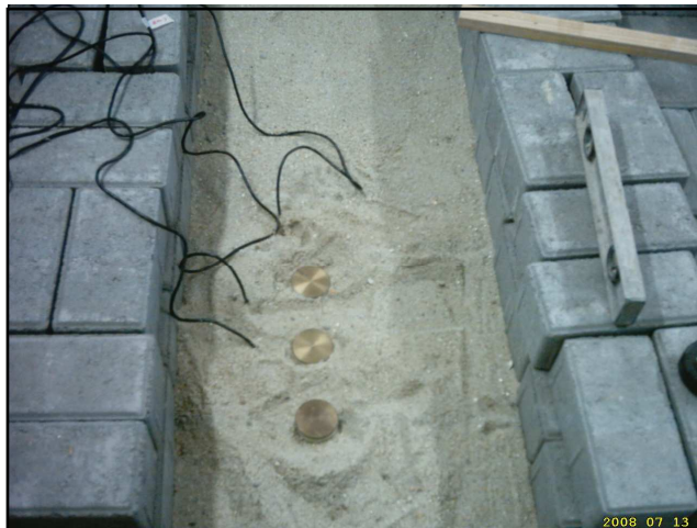
Figura 4.61: Instalação das células de carga a 10,0 cm entre si (entre a base e o revestimento intertravado do pavimento estudado).
