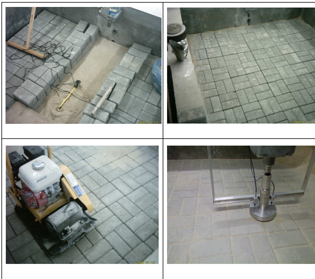
Figura 4.32: Detalhes construtivos do revestimento tipo intertravado com peças pré-moldados de concreto (PPC) no tanque-teste.
